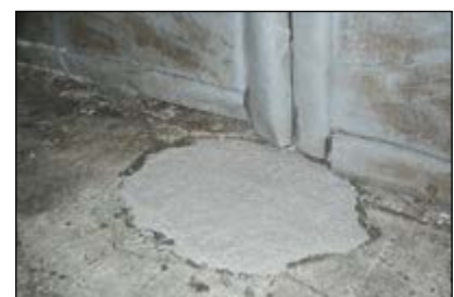
Bild oben: Deutsche See GmbH & Co. KG, Bremerhaven: Ausbesserung der Bodenflächen im Tiefkühlhaus bei laufendem Betrieb mit SILIKAL® Mörtel R 17 (-25 °C)
