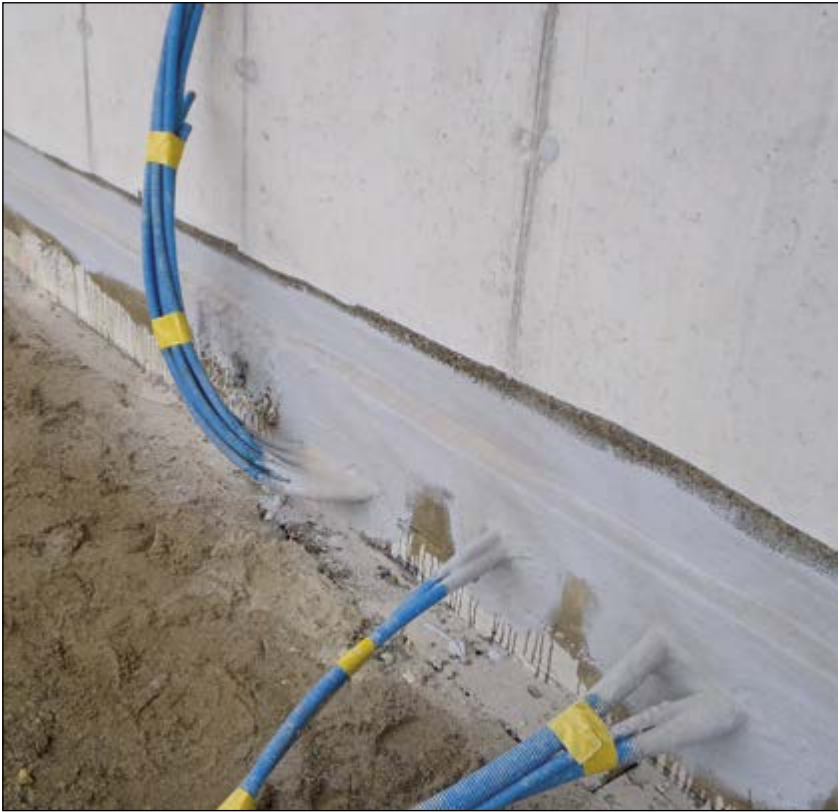
Fugenabdichtung mit Kabeldurchführungen
